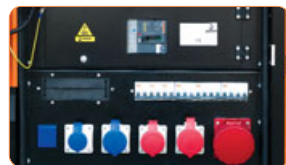
Quadro de tomadas e disjuntor tetrapolar Tomadas de alta qualidade e segurança com protecção diferencial geral, podendo ser incrementada com protecções individuais por cada tomada.
